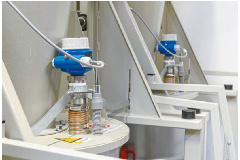
Füllstandüberwachung bei einer Absauganlage mit Schwinggabelsensoren
