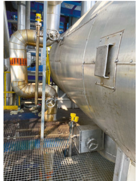
Im 3-Phasen-Separator messen geführte Radarsensoren Vegaflex 81 die Trennschicht zwischen Kohlenwasserstoff und Wasser
