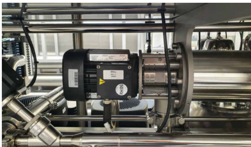
Über verschiedene Aufbereitungsstufen wird das Trinkwasser enthärtet und gefiltert
